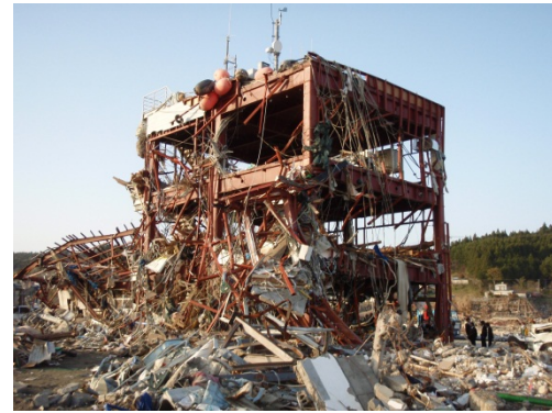
[多くの殉職者を出した防災対策庁舎]
